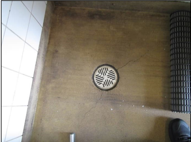
Kuva 3: Lattiapinnoite on halkeillut pesutilojen lattiakaivojen ympärillä.
