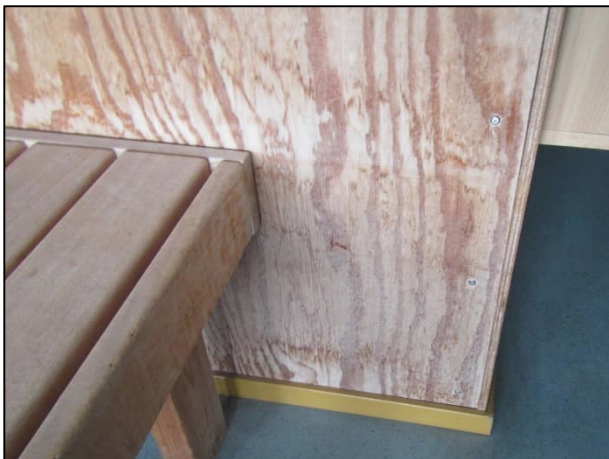
Kuva 4: Puulevyverhouksissa on paikoin kosteusjälkiä. Kuvassa saunaosaston pkh väliseinä.
