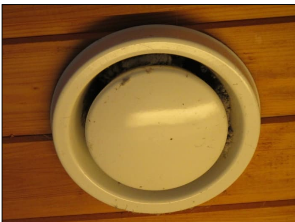
Kuva 6: Poistoilmaventtiilit sekä todennäköisesti myös ilmanvaihtokanavat ovat puhdistuksen tarpeessa.
