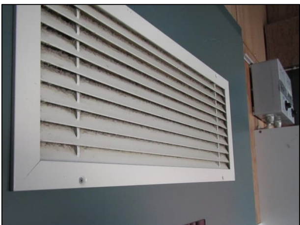
Kuva 7: Pesuhuoneen siirtoilmäsäleikkö on pölyyntynyt.
